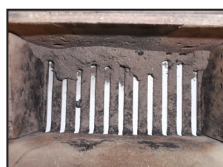
Cestello che necessita di pulizia
